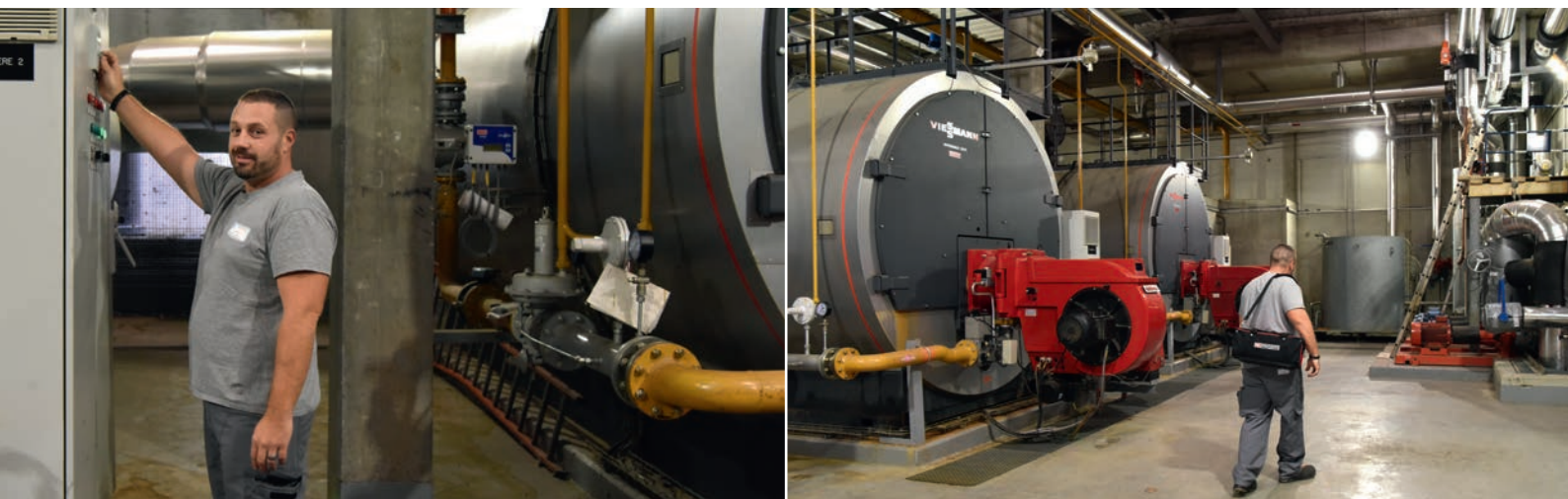
Axel Bouchet, agent de l'atelier plomberie, contrôle la bonne marche des trois colossales chaudières qui fournissent Lyon Sud en chauffage et eau chaude sanitaire.
