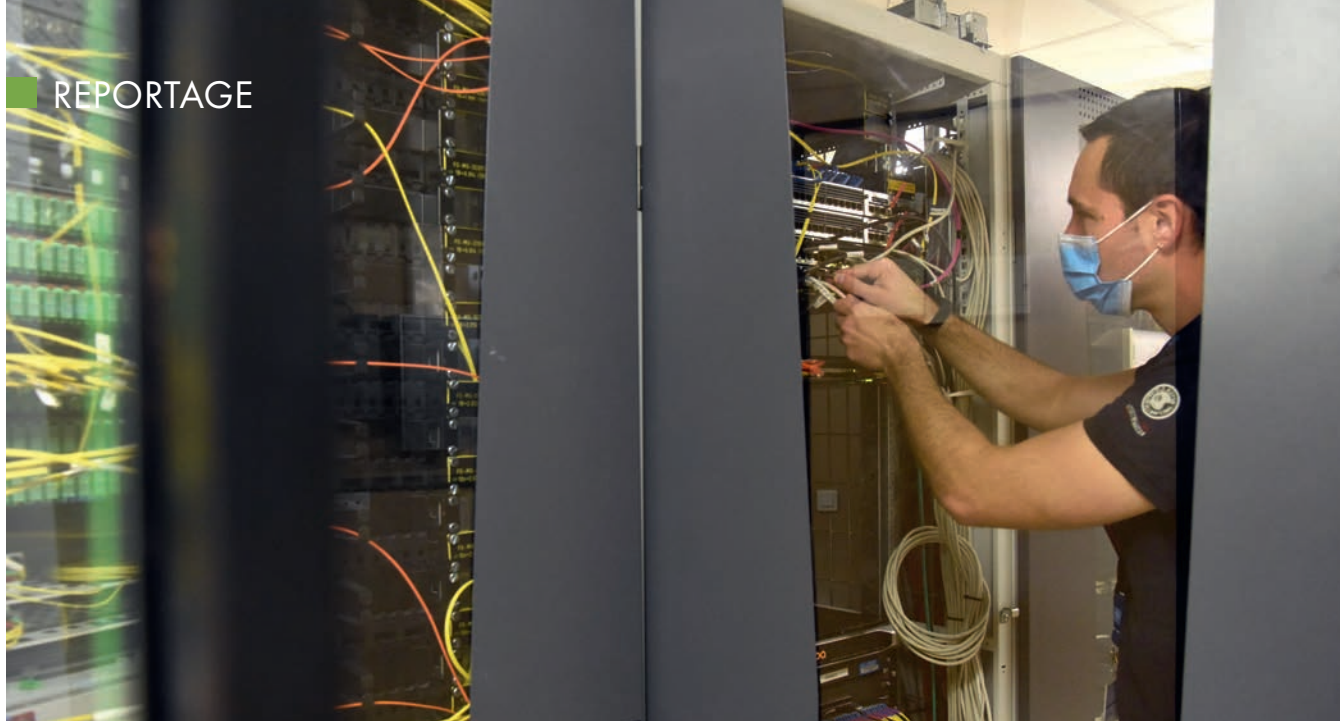
Laurent Cachot, responsable du service courants faibles vérifie régulièrement la bonne marche des installations.
